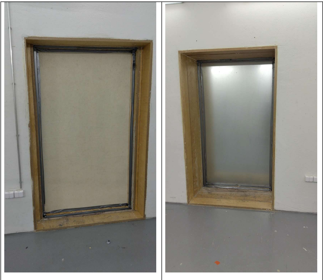
Kuva L2.1. Asennus testausaukkoon rakennettuna. Vasemmalla kuva lähetyshuoneesta katsottuna. Oikealla kuva vastaanottohuoneesta katsottuna.
