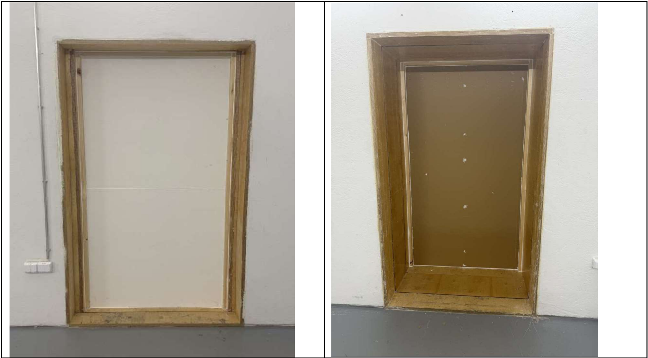
Kuva L2.1. Asennus testausaukkoon rakennettuna. Vasemmalla kuva lähetyshuoneesta katsottuna. Oikealla kuva vastaanottohuoneesta katsottuna.
